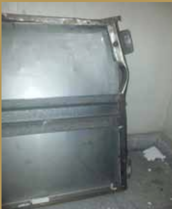
Asansörde yük taşıma sırasında transpalet ile kapıya zarar verilmesi
